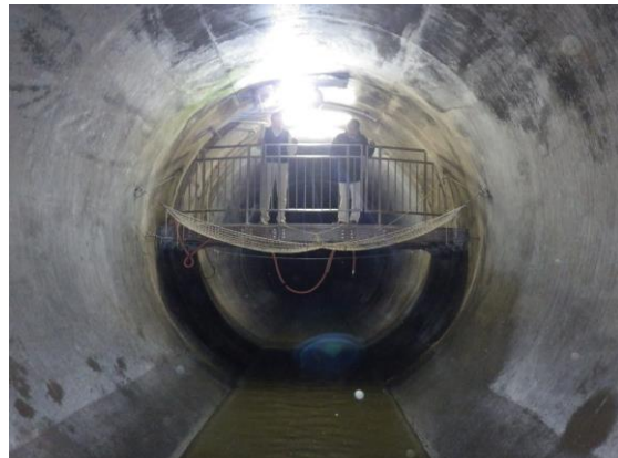
↑地下5階の下水管渠
