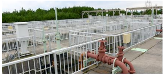
新潟県佐渡市 国府側浄化センターの沈殿地
