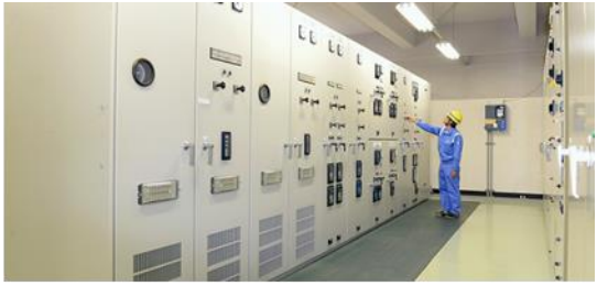
下水処理に必要な電力を供給する電気設備
