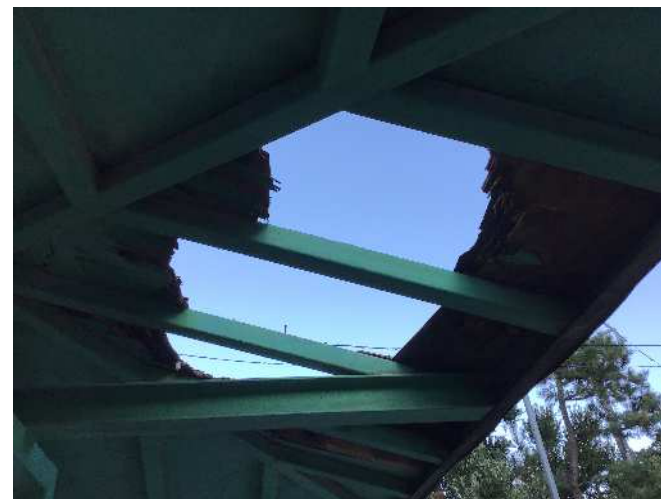
4年前の東屋の屋根の状態
