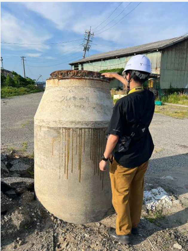
大きく飛び出したマンホール
